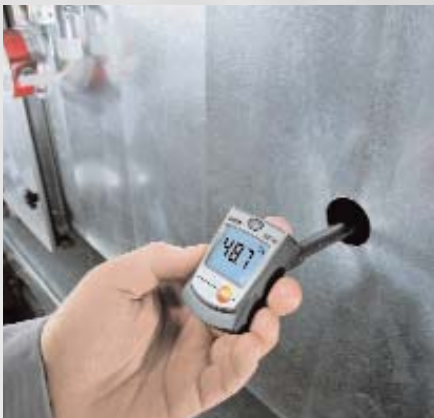
Medición de la humedad ambiente en el interior de un conducto de a/a
